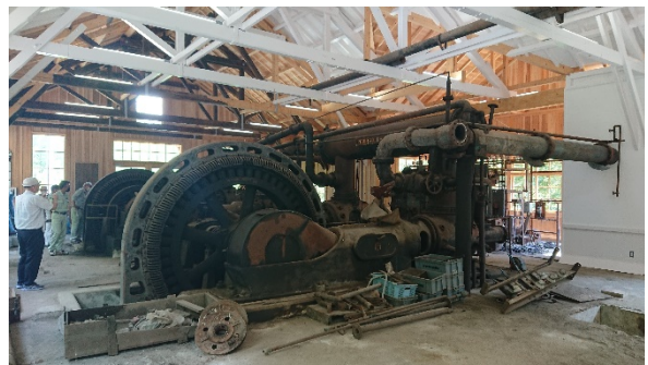
写真-2 本山動力所内の大型コンプレッサー
