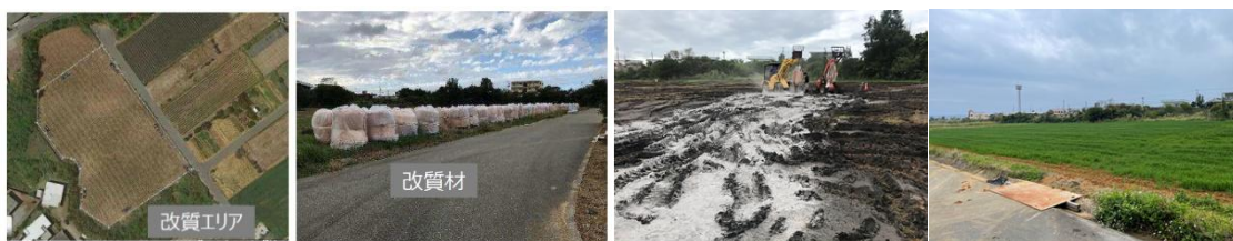
(a) 改質エリア (b) 改質材 (c) 攪拌混合 (d) 対策後牧草生育状況 写真 6.6 施工状況
