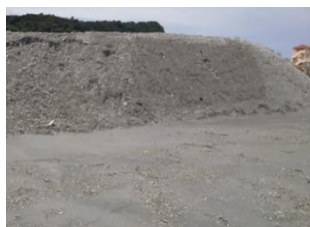
(g) 未改質土盛土 崩壊部あり（種子吹付け不可）
