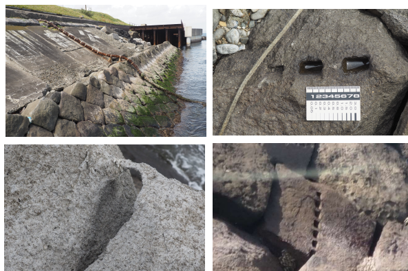
図1 第二海堡右翼北岸 護岸間知石：左上より, 西側護岸全景, 間知石の矢孔跡, 最上部波返し石の塩類風化(表面の溶解残り), 東側護岸 間知石の矢孔跡
