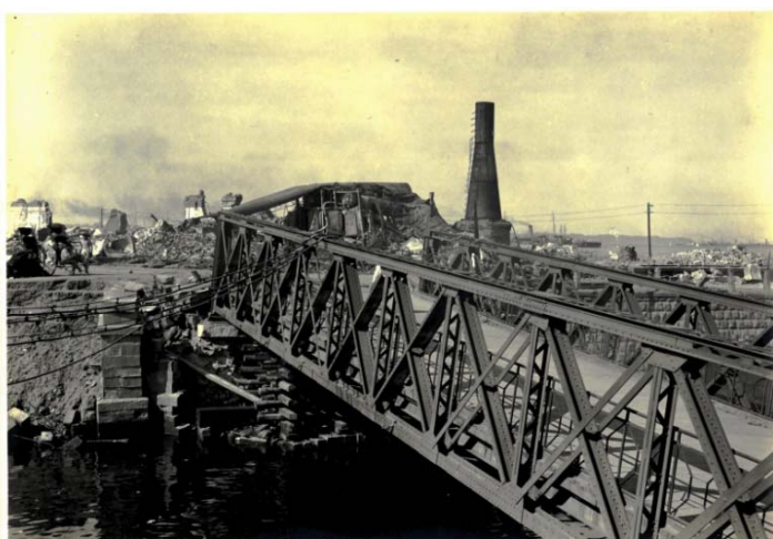
写真-1 関東地震横浜谷戸橋
